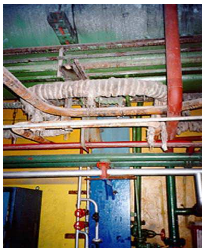
18.4.1.1.1.1.1.6 Zdjęcie 11 Izolacja rurociągów ze sznurów azbestowych w elektrociepłowni
