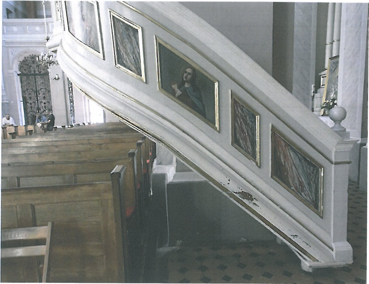
Balustrada ambony przed rozpoczęciem prac konserwatorsko- restauratorskich. Ubytki i odspojenia warstw malarskich.
